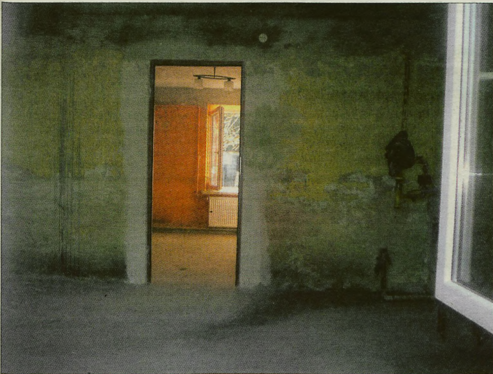
Zalane i zniszczone domy.
