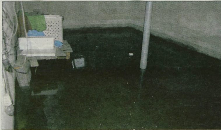
Mieszkańcy ulicy Łąkowej już po raz kolejny w tym roku musieli wypompowywać wodę ze swoich piwnic.
