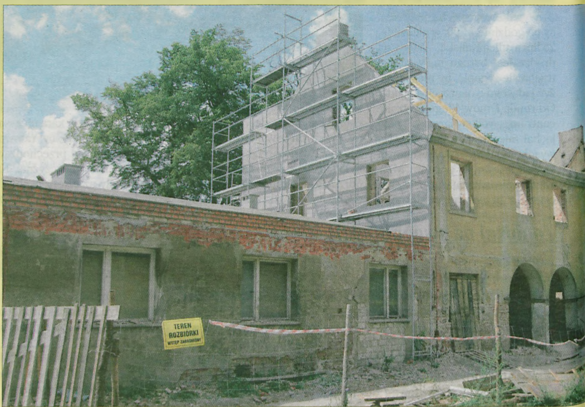
W tej chwili prowadzone są prace remontowe, ale już niedługo wozownia odzyska dawną świetność...
