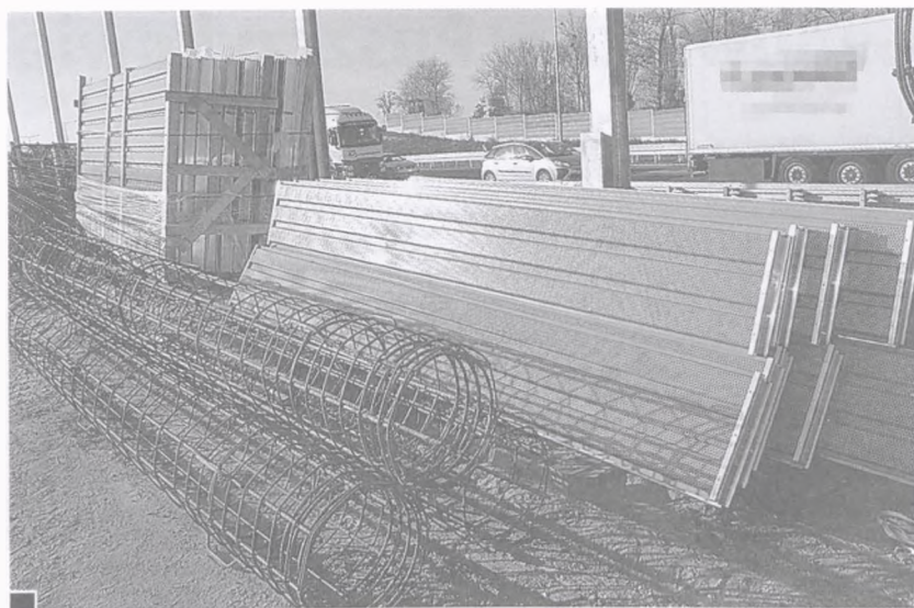
Kasetony z aluminium przygotowane do osadzenia między słupami ekranu akustycznego przy użyciu minidźwigu
