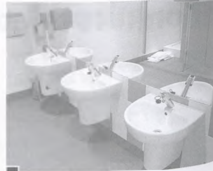
Wygodne i przestronne toalety znajdują się przy każdej sali dydaktycznej fot. Paweł Wolniewicz
