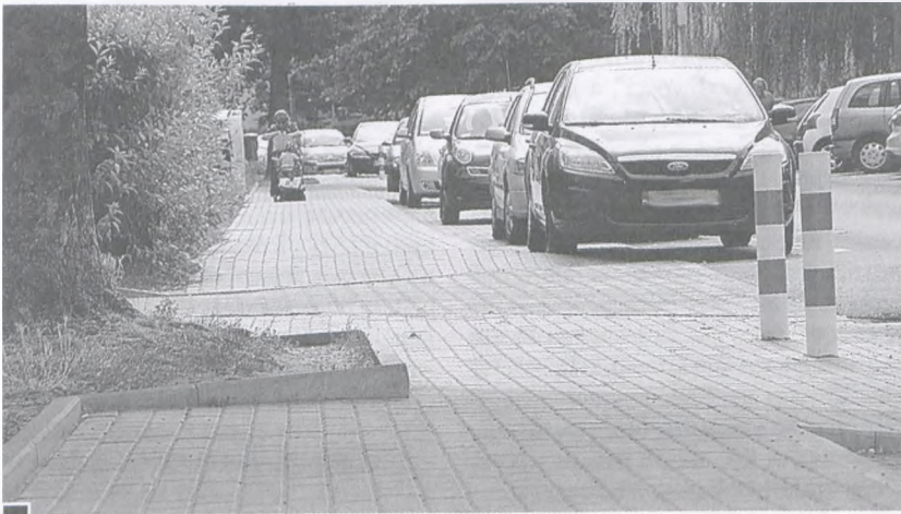
Wzrastająca klinem wysokość krawężnika oddzielającego drzewo od chodnika jest niebezpiecznym potykačem na ul. Osiedlowej fot. Piotr P. Ruszkowski
