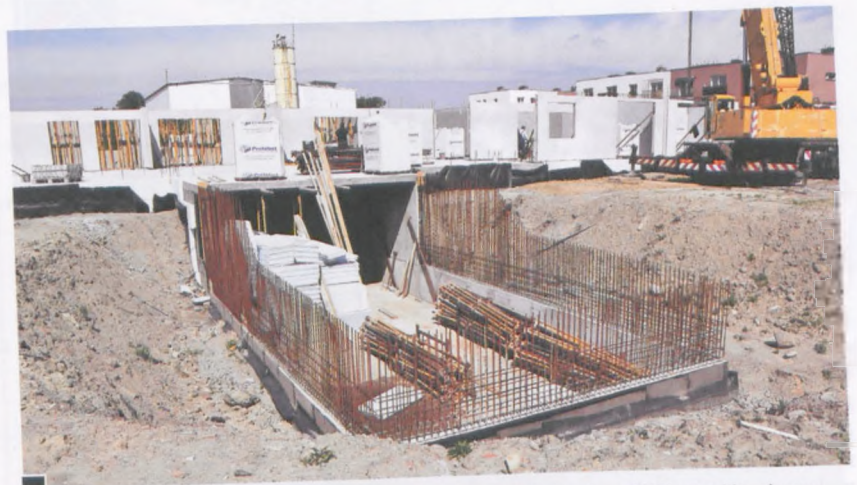
Budowa pierwszego bloku osiedla „Na Skarpie”. Widok od rzeki Warty. Na pierwszym planie przyszły wjazd do podziemnych garaży, dalej betonowe płyty ścian parteru (stan na 27 maja) fot. Piotr P. Ruskowski
