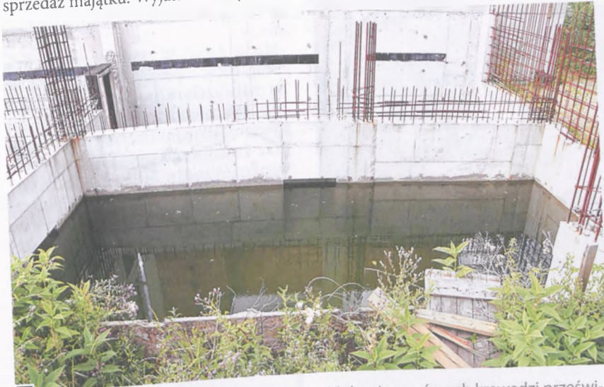
Wysokość lustra wody w podziemnej części bloku sięga górnych krawędzi prześwitu otworów drzwiowych, czyli około 2 m fot. Piotr P. Ruskowski
