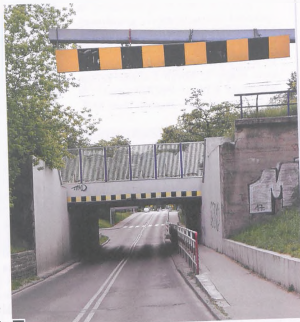
Owinięte wokół belki łańcuchy, na których pomalowane w żółto-czarne pasy znak ostrzegawczy potencjalnie ma pomagać kierowcom samochodów ciężarowych i informować, czy zmieszczą się pod wiaduktem fot. Piotr P. Ruszkowski
