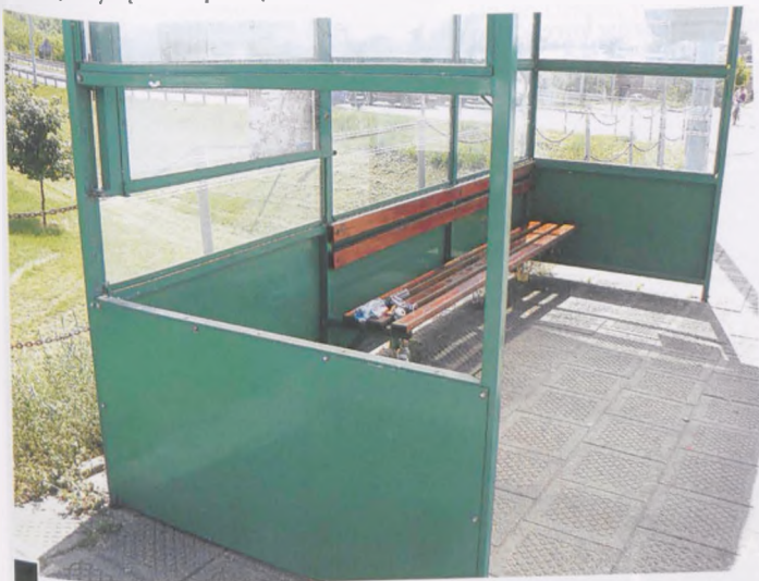
Estetyczna wiata została uszkodzona przez wandalę fot. Paweł Wolniewicz
