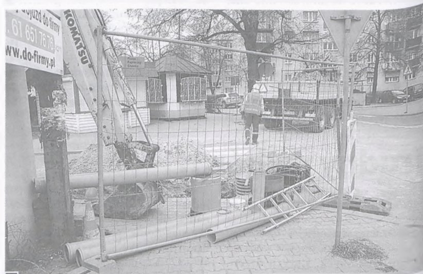
Budowa przyłącza kanalizacji sanitarnej dla pawilonów handlowych przy ul. Żabikowskiej-Osiedlowej fot. Hanna Siatka
