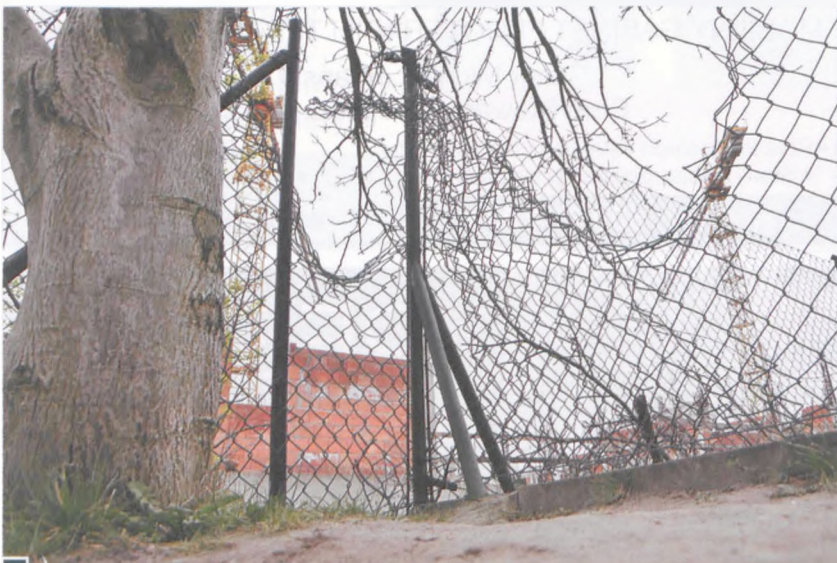
Zniszczona siatka parkanowa niebezpiecznego placu budowy od strony budynków z adresem: Wschodnia 23a i Kochanowskiego fot. Piotr P. Ruszkowski
