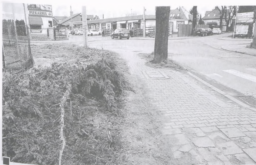
Na pierwszym planie przygotowania do modernizacji widocznego w głębi, 5-ramiennego skrzyżowania ulic: 11 Listopada, Traugutta i Rejtana – porządkowanie miejskiego terenu „odzyskanego” po przesunięciu ogrodzenia prywatnej posesji fot. Hanna Siatka
