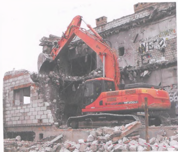
Firma burząca obiekt wywiezie z działki przy ul. Zielonej 46 tony gruzu i elementów konstrukcji, posprząta i ogrodzi teren fot. Hanna Siatka
