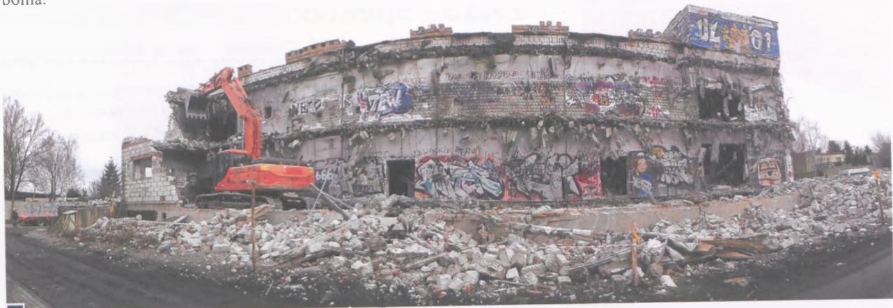
Pokryte graffiti wnętrze wyburzanego budynku – nieformalnego ośrodka kultury w Żabikowie fot. Hanna Siatka
