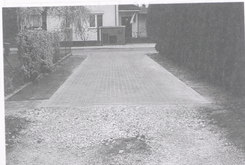
Tylko fragmentarycznie utwardzona droga do posesji przy ul. Dojazdowej 22 – firmy „Display Print” i domu jej właściciela. Zdaniem BMK, zbudowanie dojazdu w całości generowałoby problemy odwodnieniowe. Tymczasem wydaje się, że wody opadowe z powodzeniem można by skierować na gruntowe pobocza fot. Hanna Siatka
