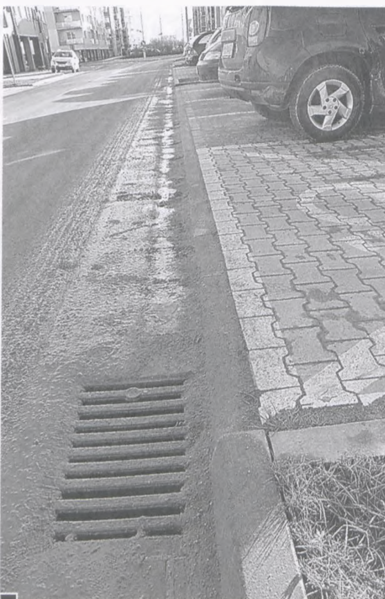
Kto nie traci wyobraźni, widzi jak zapychane muszą być rury kanalizacji deszczowej w alei JP II, jeżeli takie błoto zalega w rynsztoku. Przy konieczności nagłego hamowania, poślizg na takiej nawierzchni jest nieunikniony. Czy i jak zaradzą temu decydenci? fot. Piotr P. Ruszkowski
