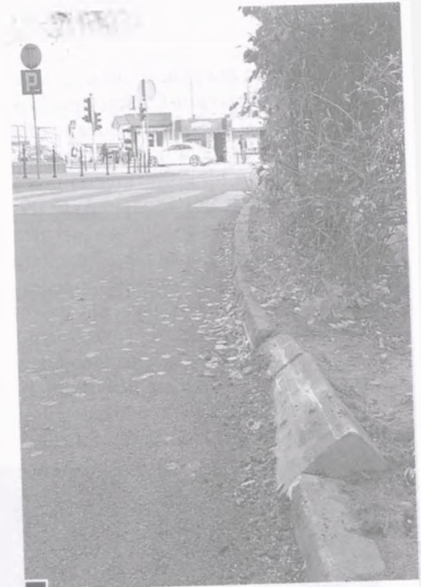
Złe zamontowane krawężniki nadają się do poprawy fot. Piotr P. Ruszkowski
