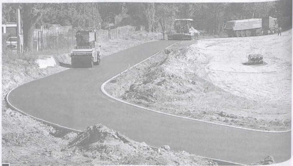
3 września kończono prace związane z budową podłoża pod bieżnię fot. Piotr P. Ruszkowski
