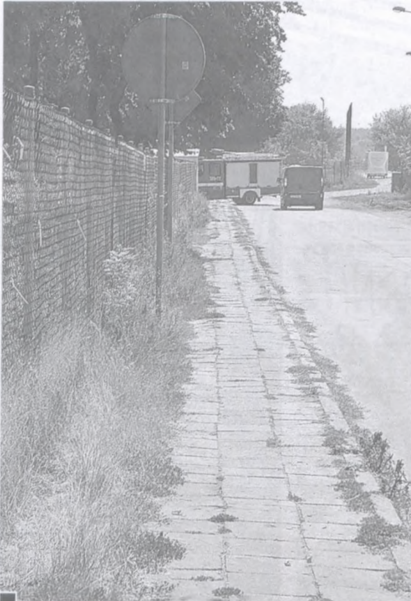
Stan chodnika na ul. Rzecznej przylegającego do stadionu i prowadzący bezpośrednio na plażę – obiekty miejskie fot. Piotr P. Ruskowski
