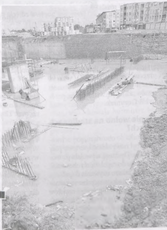
Zalane wodami opadowymi fundamenty budowanego bloku mieszkalnego przy ul. A. Mizerki fot. Piotr P. Ruskowski
