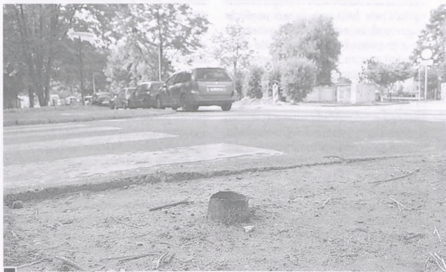
Niebezpieczny stalowy kikut przedzwiałej rury o ostrych krawędziach w przejściu na ul. Osiedlowej fot. Piotr P. Ruskowski
