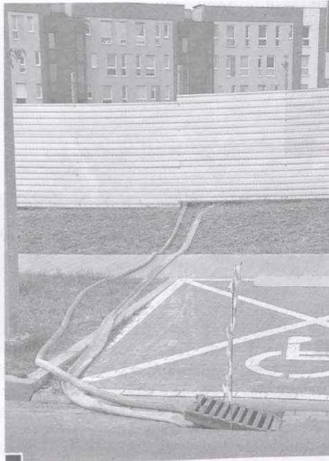
(R) Ujście węży parcianych tłoczących pod płotem zamuloną wodę wprost do guliaka kanalizacji deszczowej w al. Jana Pawła II fot. Piotr P. Ruskowski
