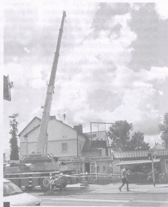
Zajęty przez dźwig pas ul. Powstańców Wlkp. podczas demontażu reklamy świetlnej (czytaj obok) fot. Hanna Siatka
