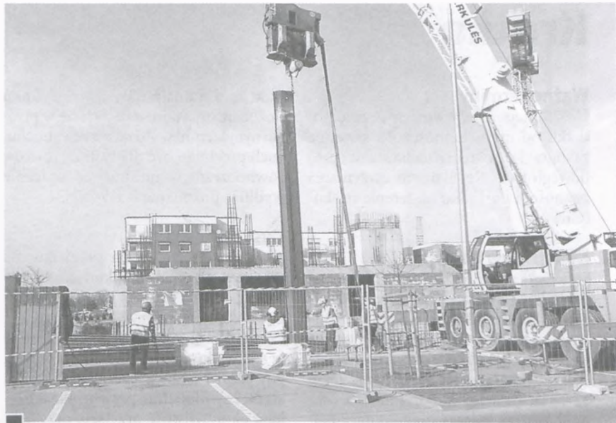
Wyciąganie ciężkich, kilkunastometrowych grodzi szalunkowych z wykopu inwestycji przy ul. Wschodniej 19 w NCL fot. Hanna Siatka
