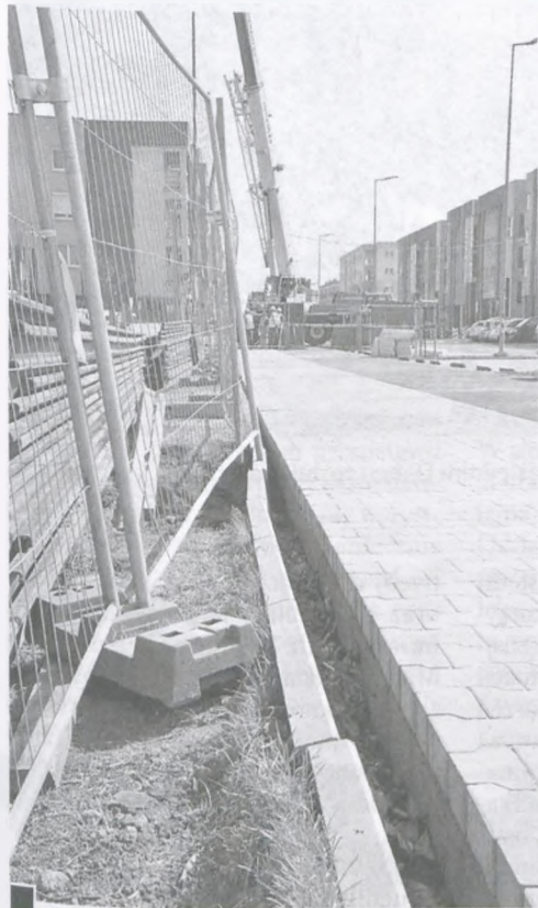
Obsunięty na szerokość kilkudziesięciu centymetrów krawężnik nowego chodnika ul. Wschodniej na wysokości placu budowy bloku przy ul. Wschodniej 19 fot. Piotr P. Ruszkowski
