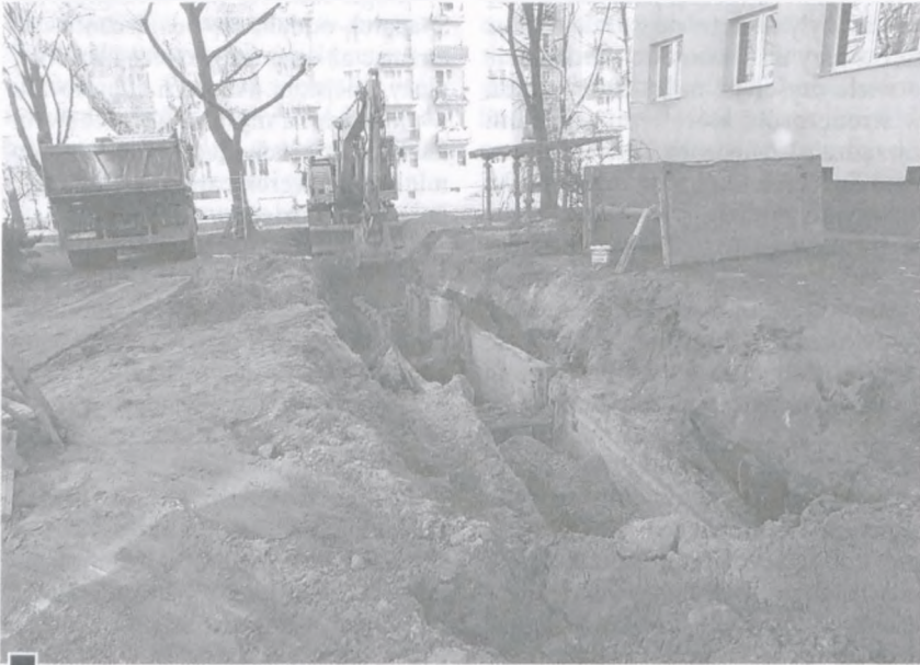
Roboty kanalizacyjne pomiędzy blokami nr 50 i 52 przy ul. Żabikowskiej fot. Hanna Siatka
