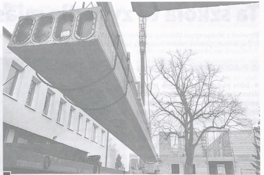
Jedna, specjalnie wzmocniona płyta stropowa do przykrycia sali gimnastycznej, nad którą będą dwa inne duże pomieszczenia, ma 17 m długości i waży 13 ton. Potrzeba było 22 takich elementów. Od 6 marca na plac budowy zwoziły je dłużycę aż z Ostrowa, gdzie produkuje je renomowana firma Consolis – największy w Europie producent prefabrykatów betonowych fot. Piotr P. Ruszkowski
