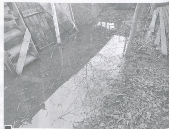
Stojąca woda gruntowa na podwórku posesji przy ul. Szymanowskiego
