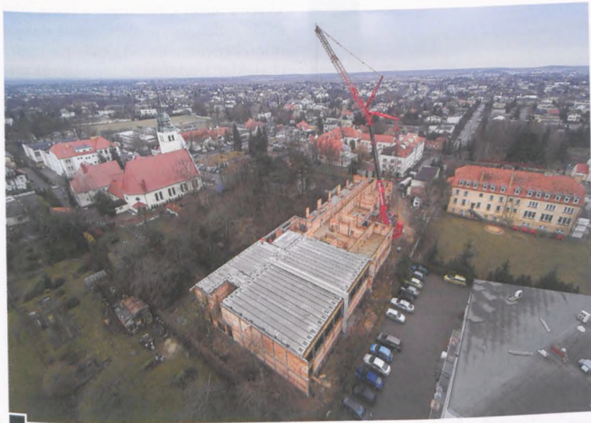
Plac budowy szkoły katolickiej w Żabikowie widziany z lotu ptaka od strony autostrady A2. Z lewej – kościół św. Barbary, z prawej – budynek Centrum Duchowości bł. Edmunda Bojanowskiego na terenie Zgromadzenia Sióstr Służebniczek NMP, a poniżej dach Sali Bankietowej „Lacerta” i jej parking. U dołu z lewej – prywatne działki. Pomiędzy kościołem a szkołą – ogród parafialny i tzw. doktorówka. Na budowanym obiekcie widać położone belki stropowe drugiej kondygnacji, w tym na przyszłej sali gimnastycznej fot. Rafał Wojtyński
