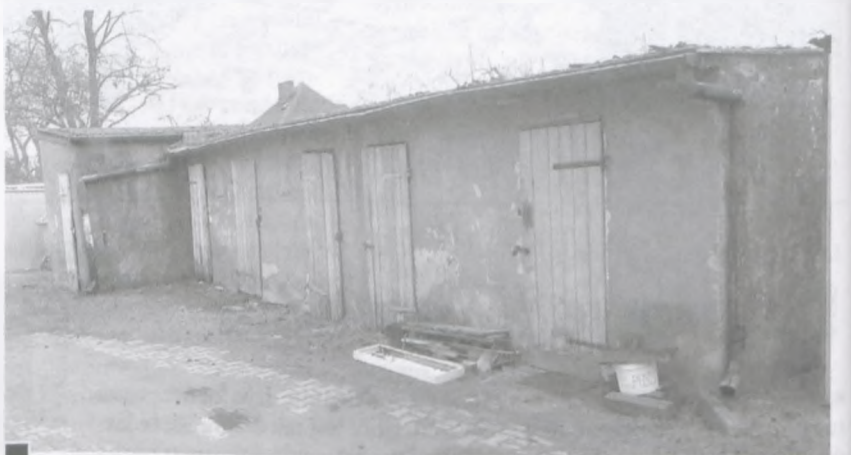
Rozsypane szopki – przeżytek sprzed kilkadziesiąt lat – miały być dawno temu rozebrane fot. Hanna Siatka
