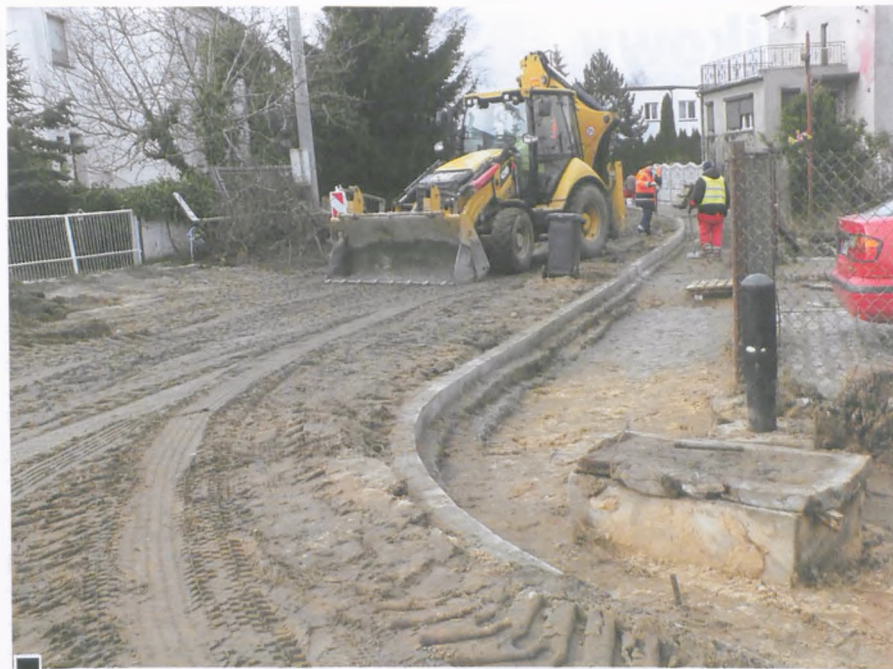
Kompleksowa budowa ul. Kasprzaka. W gruncie gotowa kanalizacja deszczowa, położono krawężniki, powstaje chodnik z kostki betonowej. Na koniec jezdni, wykorytowana na głębokość 20 cm, zostanie wysypana kruszywem bazaltowym fot. Hanna Siatka
