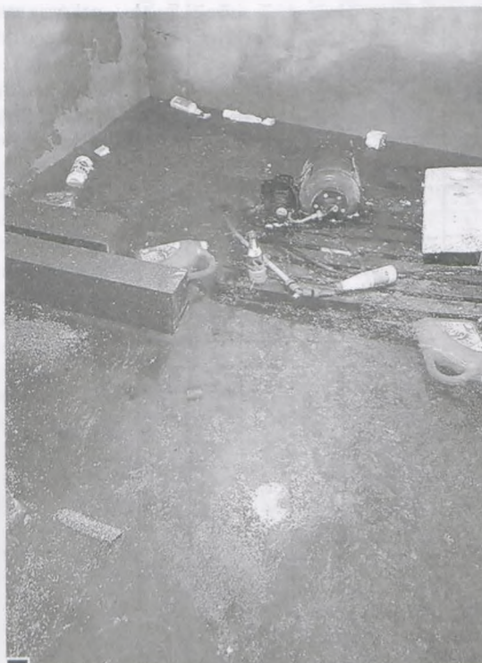
Skutkiem wysokiego poziomu wód gruntowych są zalwane piwnice. Podobny problem przez wiele lat mieli mieszkańcy ul. Fabrycznej. Wielokrotnie o nim pisaliśmy. Został przez miasto w końcu rozwiązany
