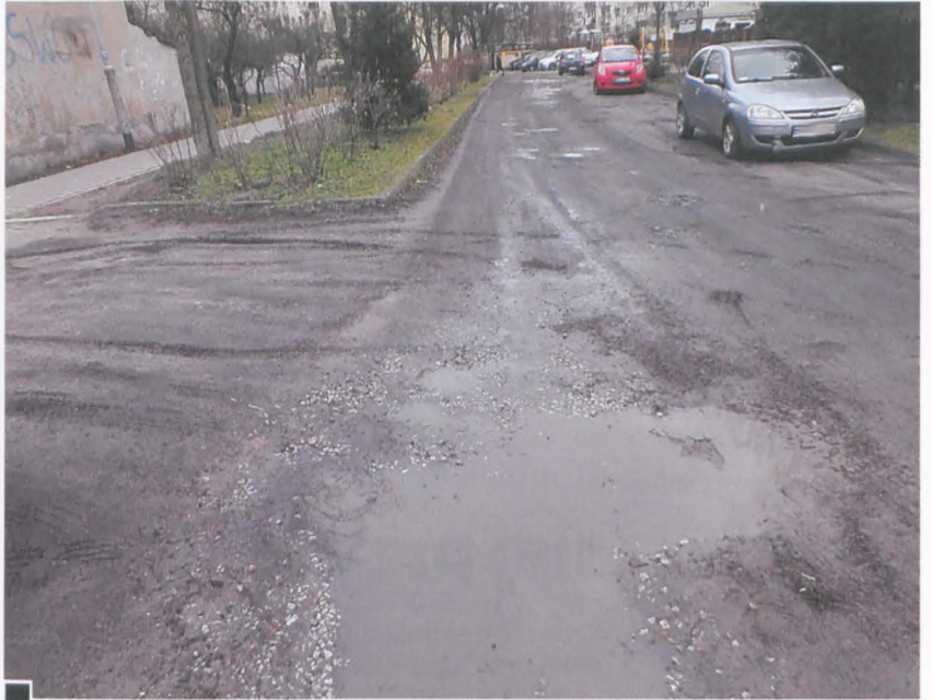
Kilkudziesięciometrowy dojazd do bloków z adresem: ul. Żabikowska 46 i 48 od ul. Kościuszki – dziurawy jak wiele jeszcze ulic w Luboniu. Z lewej – niedawno wykonany chodnik, wybudowany w miejscu przejścia, które przez lata pozostawało w skandalicznym stanie fot. Hanna Siatka
