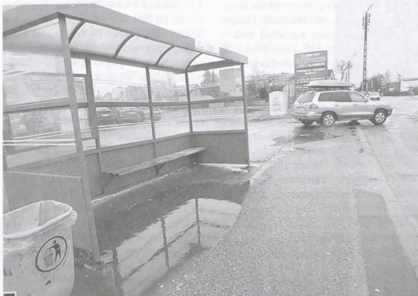
Wypełnione wodą wnętrze wiaty autobusowej na wysokości CH „Venus” fot. Hanna siatka
