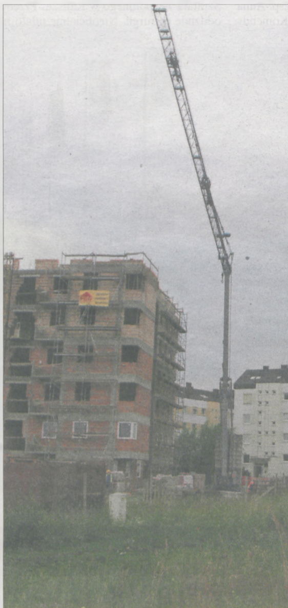
Mieszkańcy osiedla Rzeczypospolitej obawiają się, czy dźwig, który stoi przy budowanym wieżowcu nie przewróci się na ich blok
