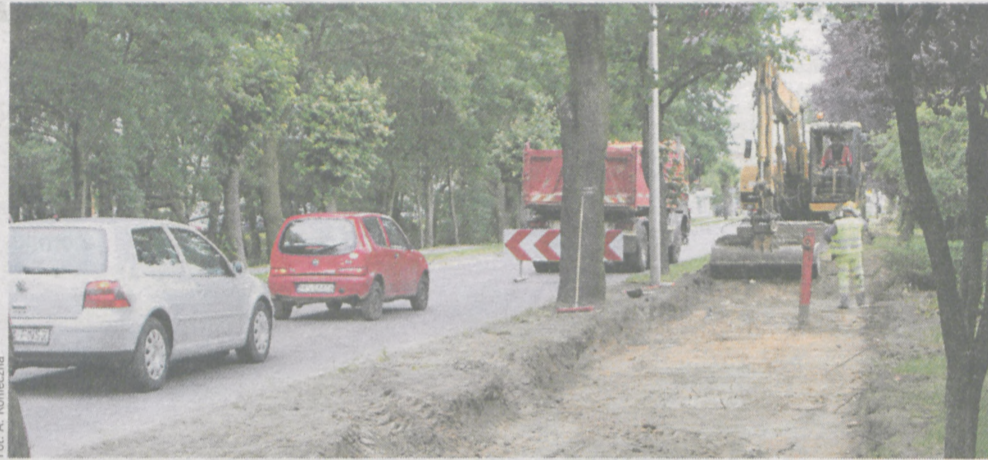
Wzdłuż ulicy Wrocławskiej i nowego łącznika powstanie ścieżka rowerowa, która połączy ulice Powstańców Wlkp. z nową obwodnicą Jarocina. Jej budowa od strony ulicy Wrocławskiej już się rozpoczęła
