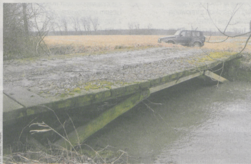
W wyniku ekspertyzy stwierdzono naruszenie konstrukcji drewnianego mostu w Brzostowie
