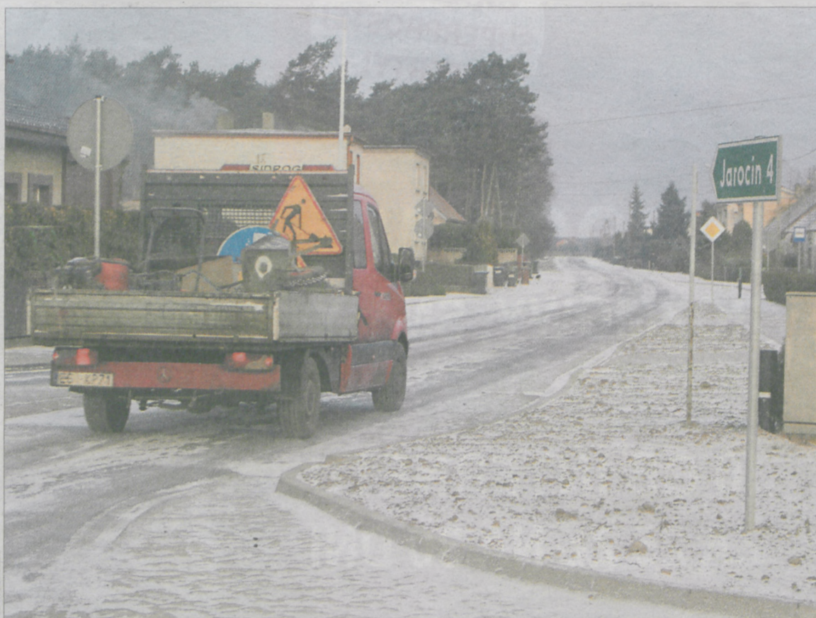
Na całym odcinku przebudowanej drogi Witaszyczki - Zakrzew stwierdzono wiele usterek. Wykonawca musi je teraz naprawić, żeby inwestycja mogła zostać odebrana
