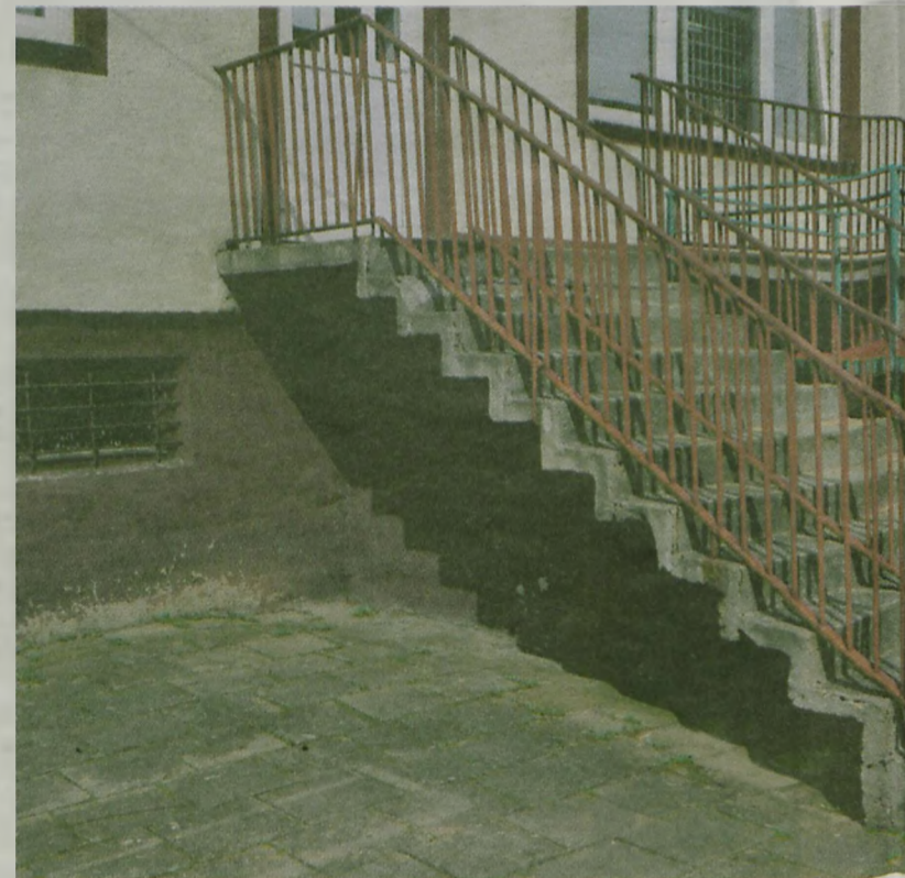
Schody z tyłu budynku także wymagają szybkiego remontu.
