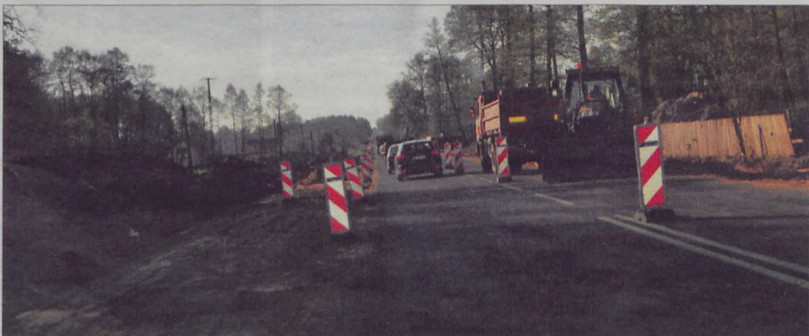
Utrudnienia występują na odcinku pięciu kilometrów. W wielu miejscach budowlancy kierują ruchem.
