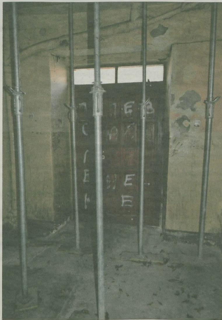
Budynek przy pl. Sienkiewicza 11 jest w oplakany stan. Od kilku lat sufity podparte są wspornikami, bo zagrażają bezpieczeństwu, do tego stopnia, że drzwi wejściowe zamknięto na trzy spusty. Dostać się do kamienicy można tylko od podwórka.
