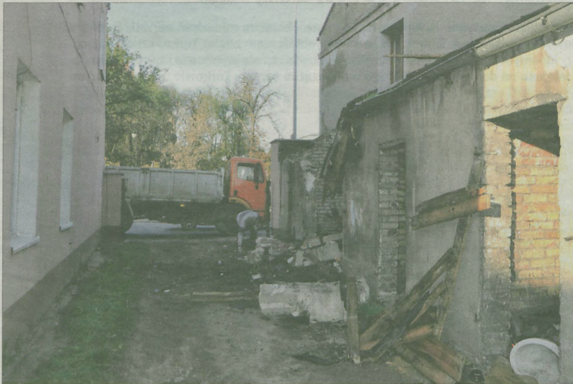
Prawdą jest, że stare i zniszczone drwalniki szpeciły kamienice przy pl. Sienkiewicza.
