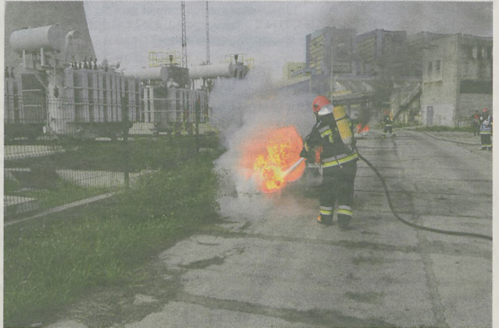
Ćwiczenia w elektrowni zakładały pożar transformatora i znajdującego się w nim oleju.
