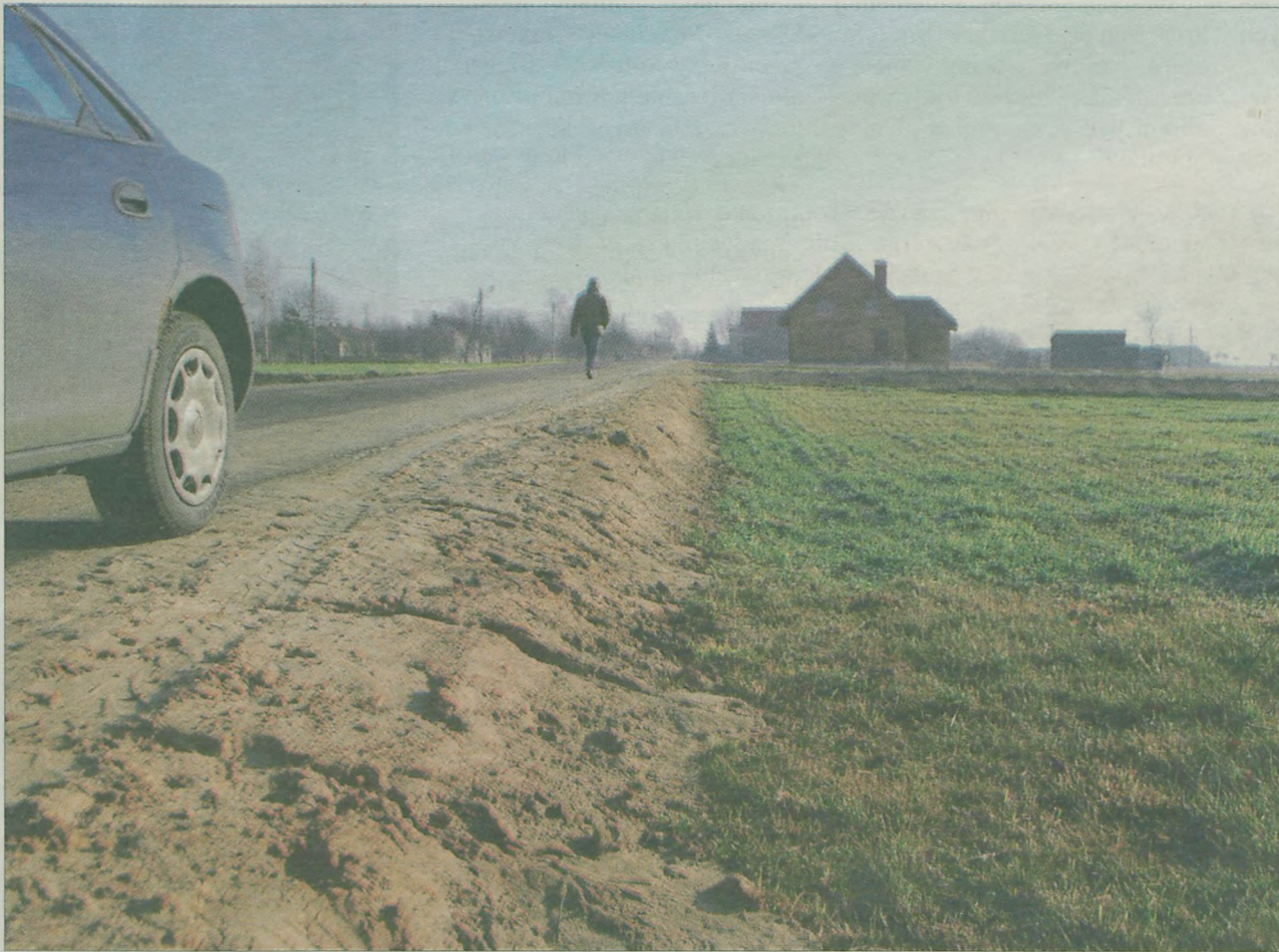
Pole Tadeusza Suleja położone jest czterdzieści centymetrów niżej niż asfalt. Co prawda rolnik może wjeżdżać na swoje pole, ale ze szkodą dla nowej drogi. Bo każde narzędzie rolnicze będzie zawieszając się na jej powierzchni i niszczyć asfalt.
