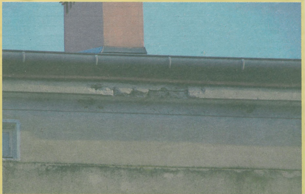
Takie uszkodzenia raczej wydają się być wynikiem zakładania rynien niż - jak uważa burmistrz Czaplą - anten.
