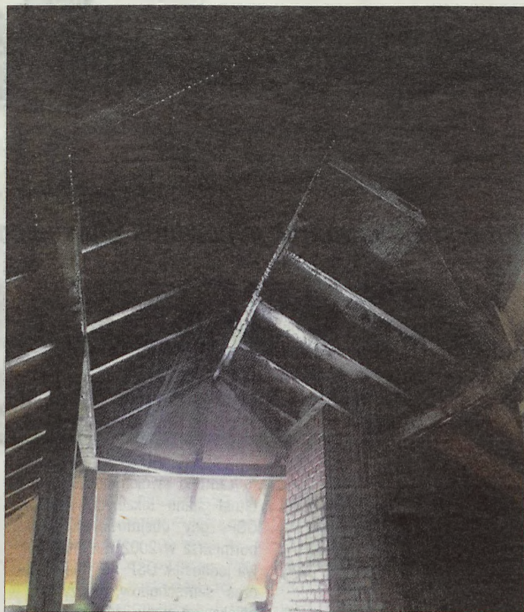
Niektóre elementy upalonej więźby dachowej przyjdzie pewnie wymienić.
