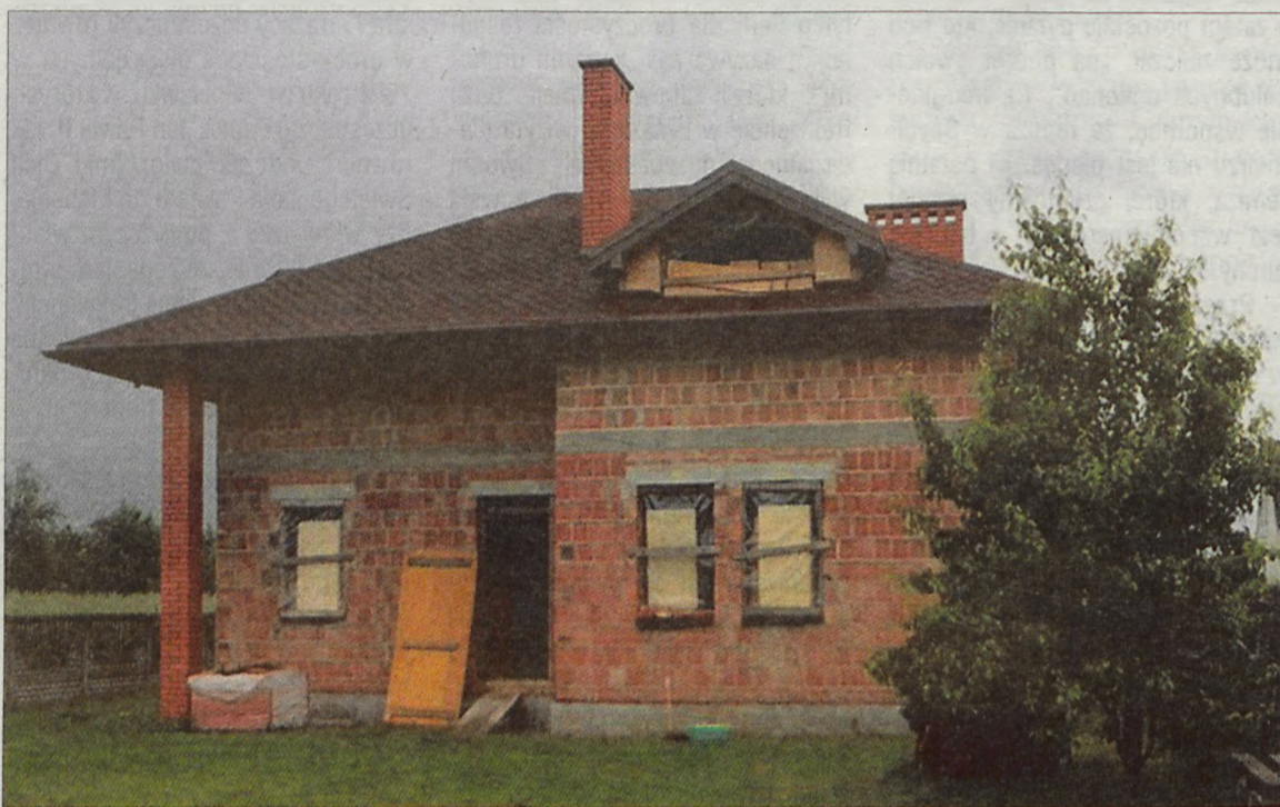
Pożar wybuchł na poddaszu jeszcze niezamieszkałego domu.
