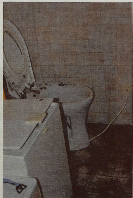
W piwnicy domu zaadaptowanej na mieszkanie, wybiła kanalizacja. By zlikwidować smród, właściciele posesji będą musieli nie tylko skuć podłogi, ale także i ściany.
