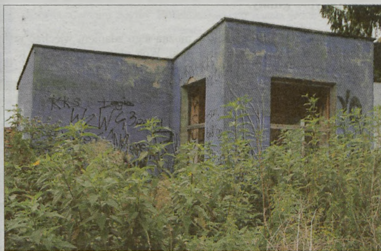
Większość budynków przy dawnej kolei straszy powybijanymi szybami.
