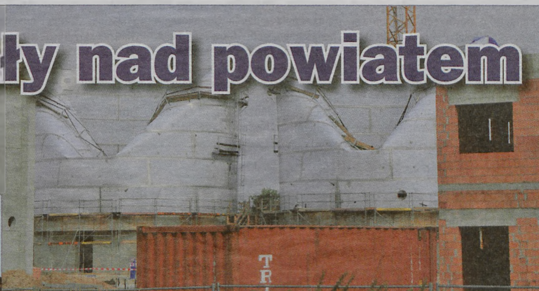
Niedzielną burza zniszczyła też silosy powstające na terenie Tureckiej Strefy Inwestycyjnej.
