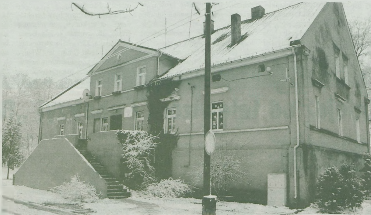
Dwór w Długiej Wsi wymaga generalnego remontu i adaptacji na potrzeby przedszkola.
