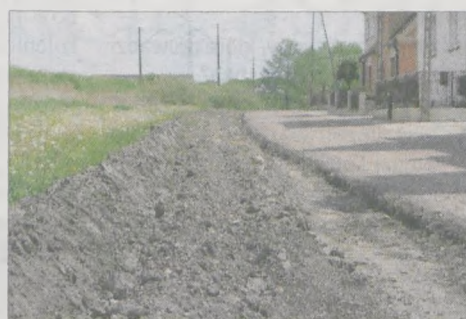
Tak wyglądało przyorane pobocze drogi
