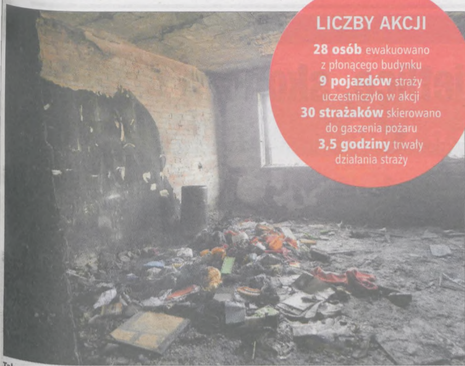
Tak wyglądało mieszkanie, w którym wybuchł pożar
