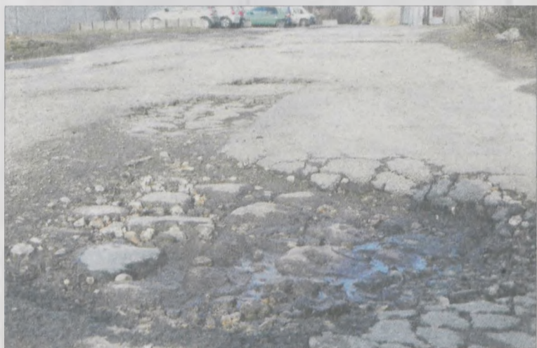
Nietrudno wpaść w dziurę na ulicy Ceglanej
