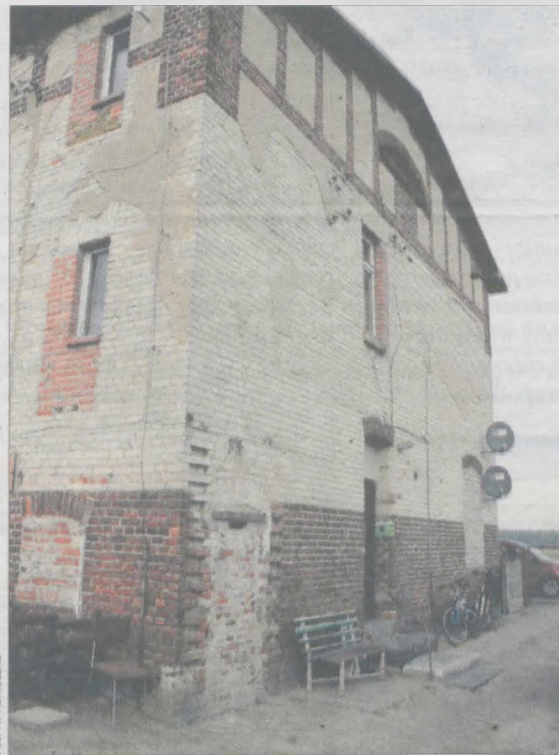
Mieszkańcy gminnego budynku w Chrzanie obawiają się, że burmistrz Żerkowa nie dotrzyma obietnic o remoncie obiektu. Ich zdaniem pękające ściany i wilgoć zagrażają zdrowiu i życiu
