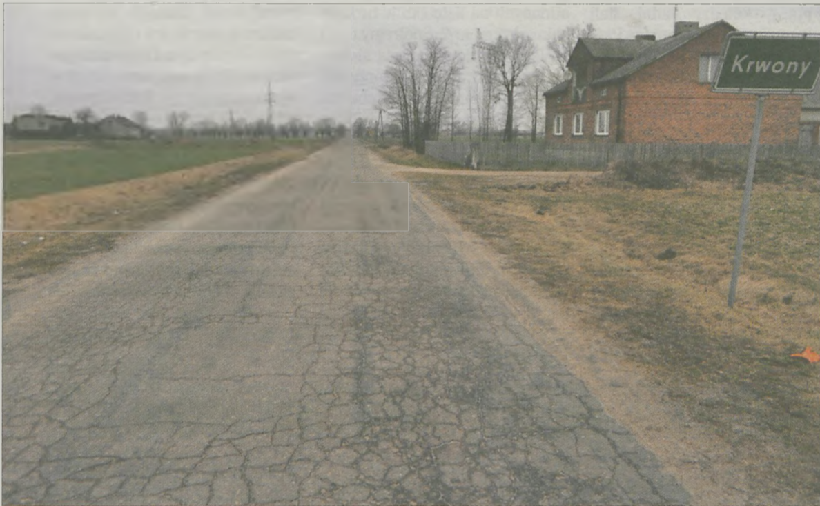
Niedawno remontowana droga w Krwonach, w kierunku na Bogdałów już jest popękana - mówił Władysław Karski.
