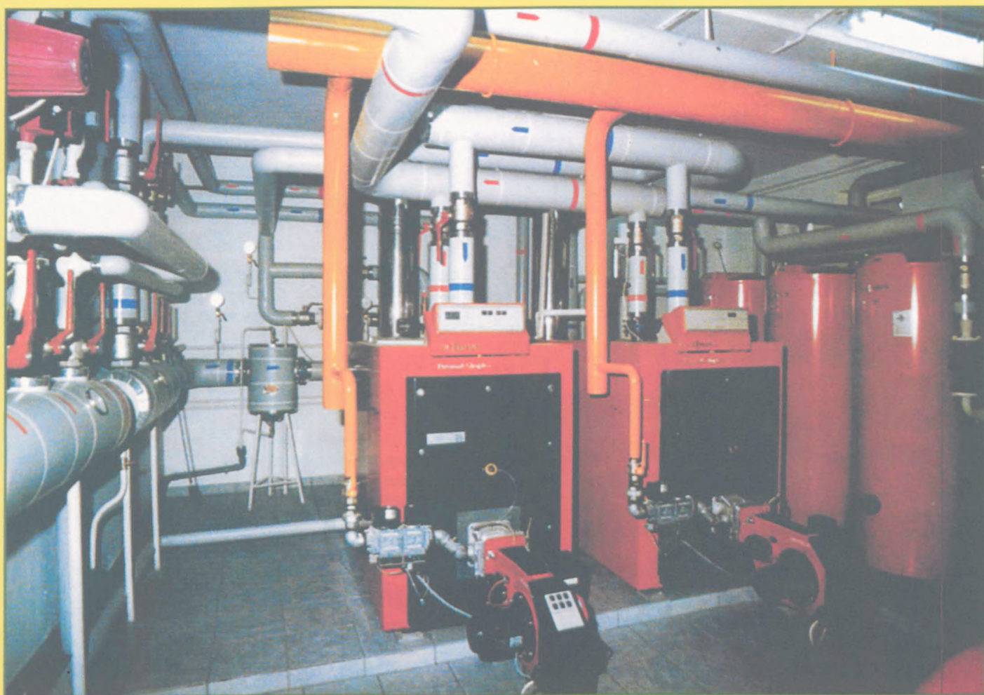
Kotłownia gazowa 450 kW - SM Manieczki /1998 r.
