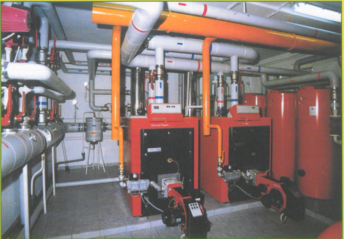
Kotłownia gazowa 450 kW - SM Manieczki /1998 r.
