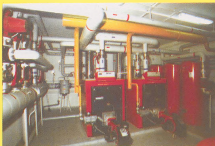
Kotłownia 450kW - Manieczki - Viessmann
