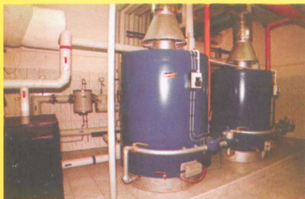
Kotłownia gazowa 360kW - ZOZ P-ń Grunwald
