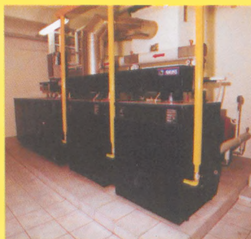
Kotłownia gazowa 300kW - ZOZ Poznań-Wilda
