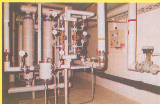
Węzeł cieplny co i cw 1.300kW - POSiR Poznań
