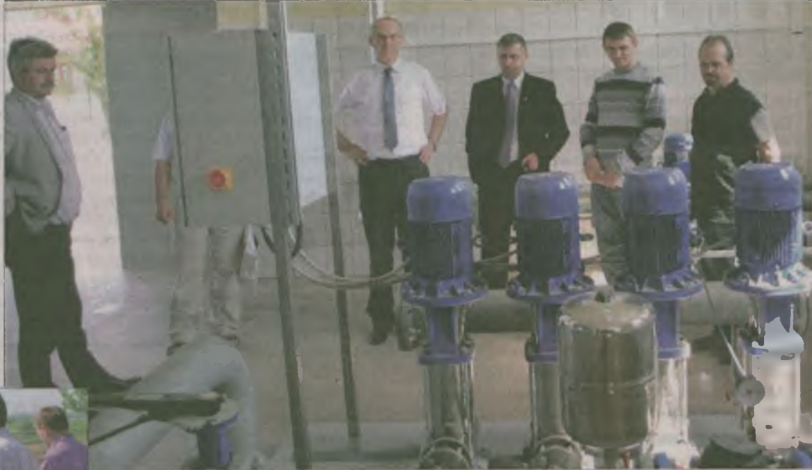
W wyremontowanych, wyłożonych płytkami pomieszczeniach zainstalowano nowoczesne urządzenia.
