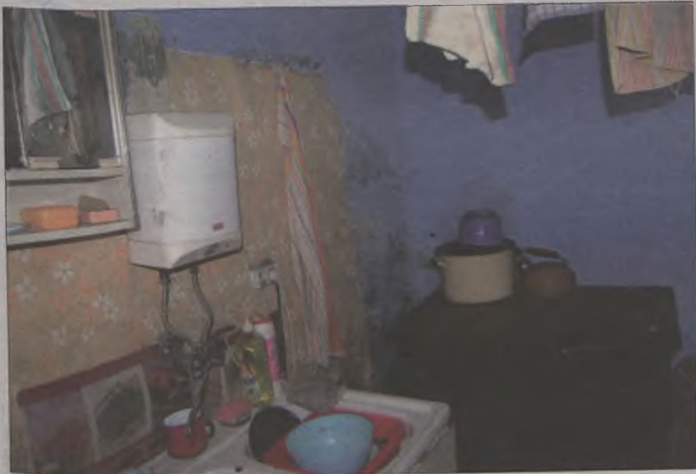
W kuchni widać zacieki, gdyż za ścianą już nikt nie mieszka.
