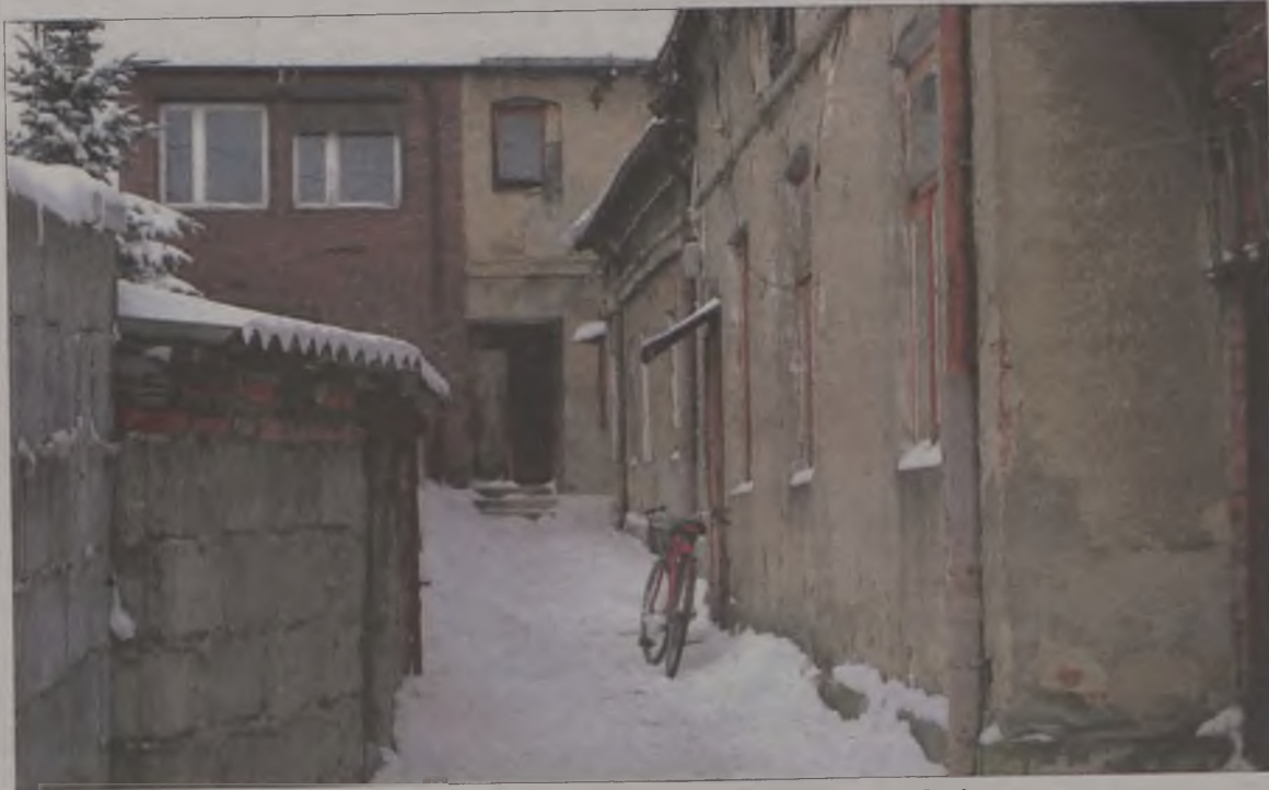
Oficyna przeznaczona jest do rozbiórki, gdyż w każdej chwili grozi zawaleniem.
