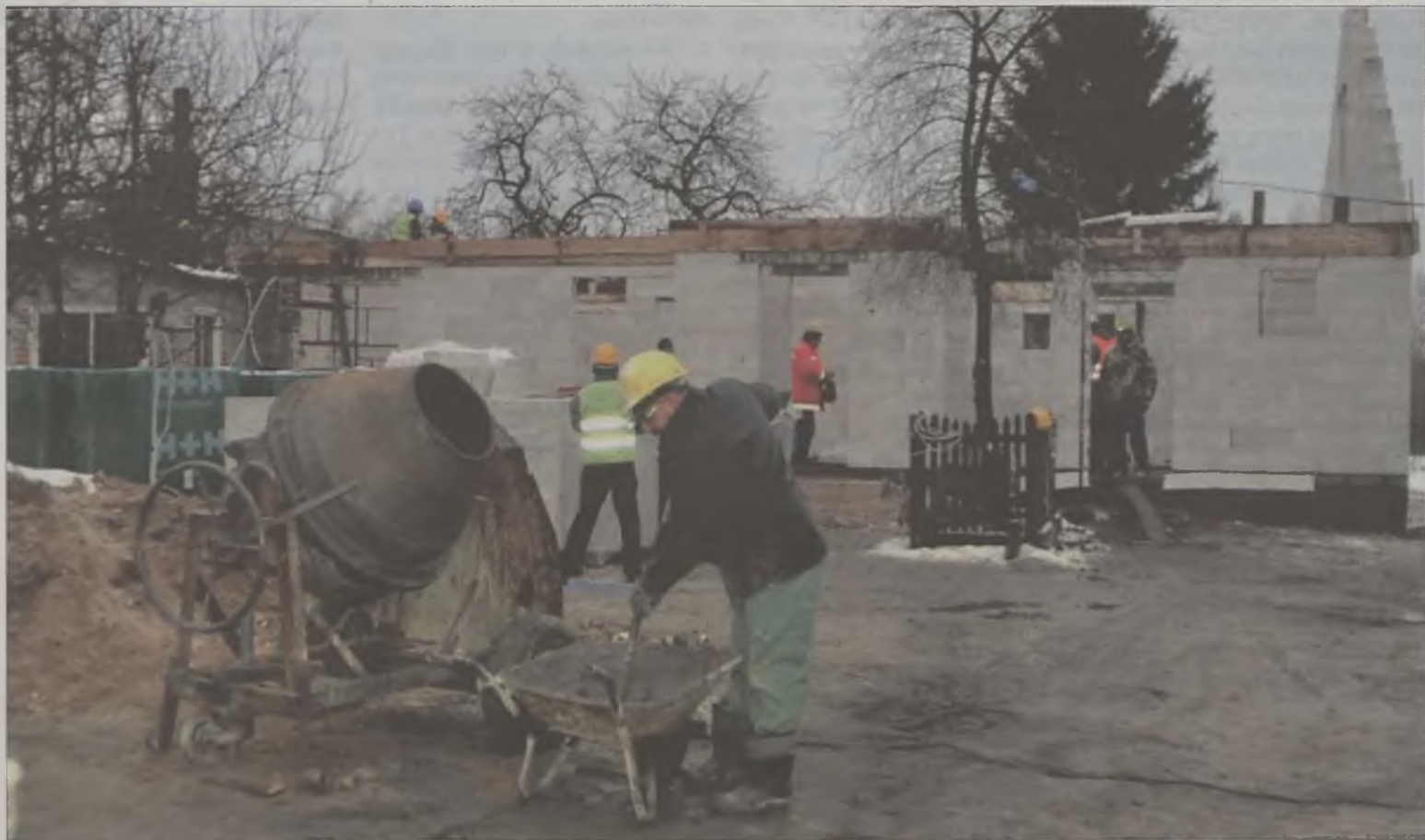
Do pomocy przy odbudowie zniszczonego domu zgłosiło się wielu chętnych. W rękach kilkudziesięciu mężczyzn, którzy pracują charytatywnie, robota dosłownie pali się w rękach.
