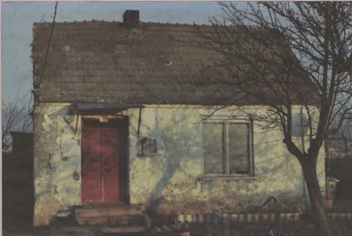
Niewielki domek, w którym rodzina mieszka od siedemnastu lat w każdej chwili może się zawalić.
