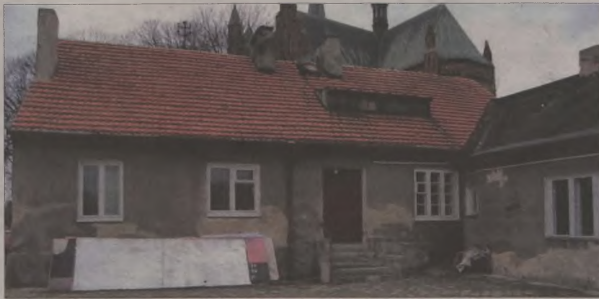
Niejednym z Czytelników niecierpliwi się z pytaniem – I co dalej? Antoni Karolak zapytany o dalsze plany wobec swojego nabytku zapowiada, że z uwagi na techniczny stan nieruchomości planuje jej szybką rozbiórkę.
