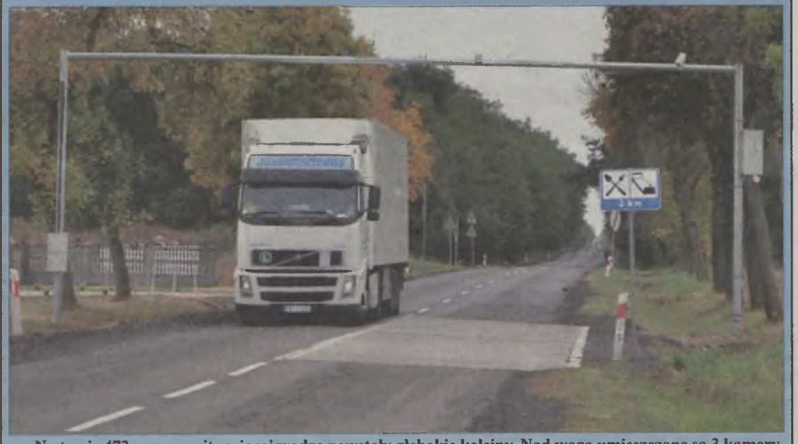
Na trasie 473 przy monitorującej wadze powstały głębokie koleiny. Nad wagą umieszczone są 3 kamery.
