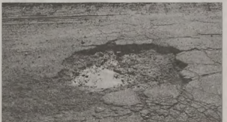
Dziury w jezdni dochodzące do 1,5 metra są stałym elementem dróg powiatowych na terenie gminy Dobra.
