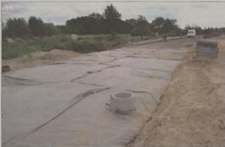
Metoda tzw. drenażu francuskiego zastosowana podczas budowy Z5, by przeciwdziałać skutkom podwyższonego poziomu wody jaki zaobserwowano podczas budowy
