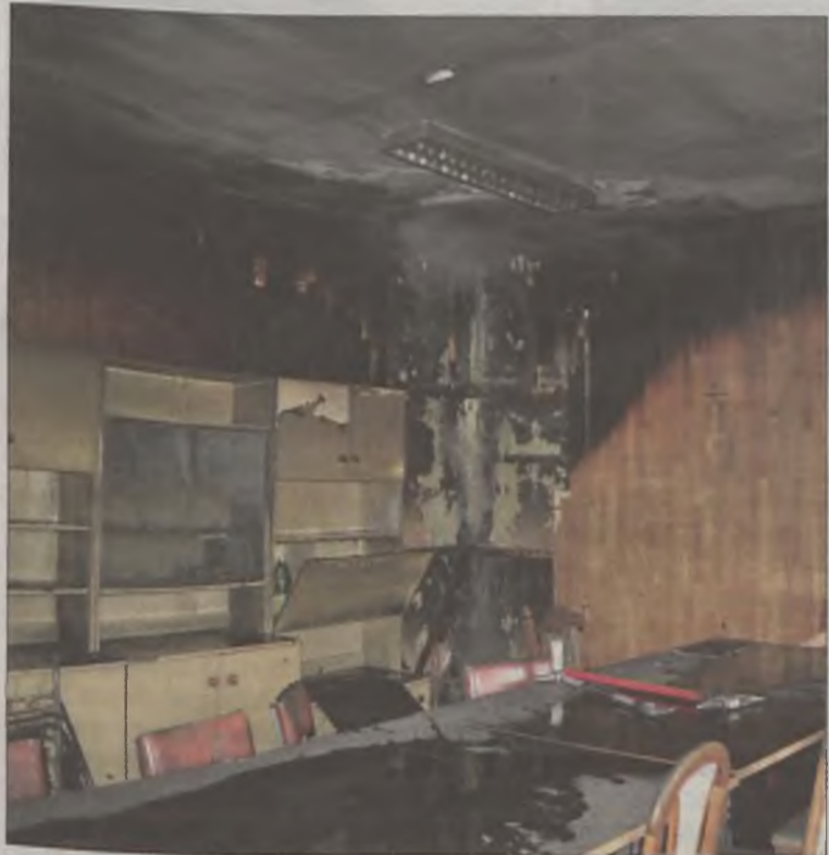
Przyczyną pożaru było prawdopodobnie zwarcie w instalacji elektrycznej budynku.
