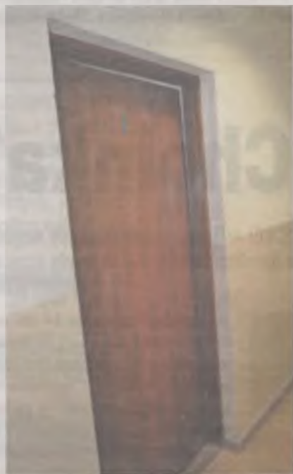
Smród odchodów wydobywa się z drzwi bez klamki, wyrwanych z zawiasów i opartych o futrynę.
