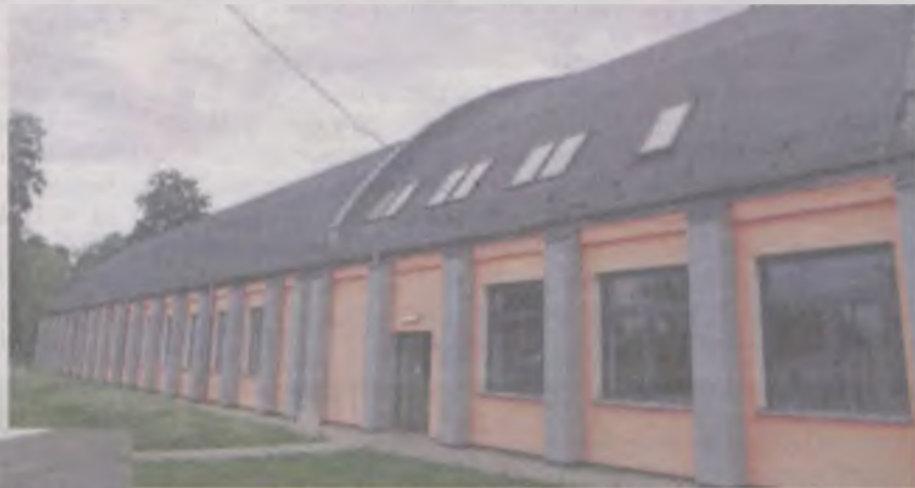
Problem stanowi południowa część dachu hali.
