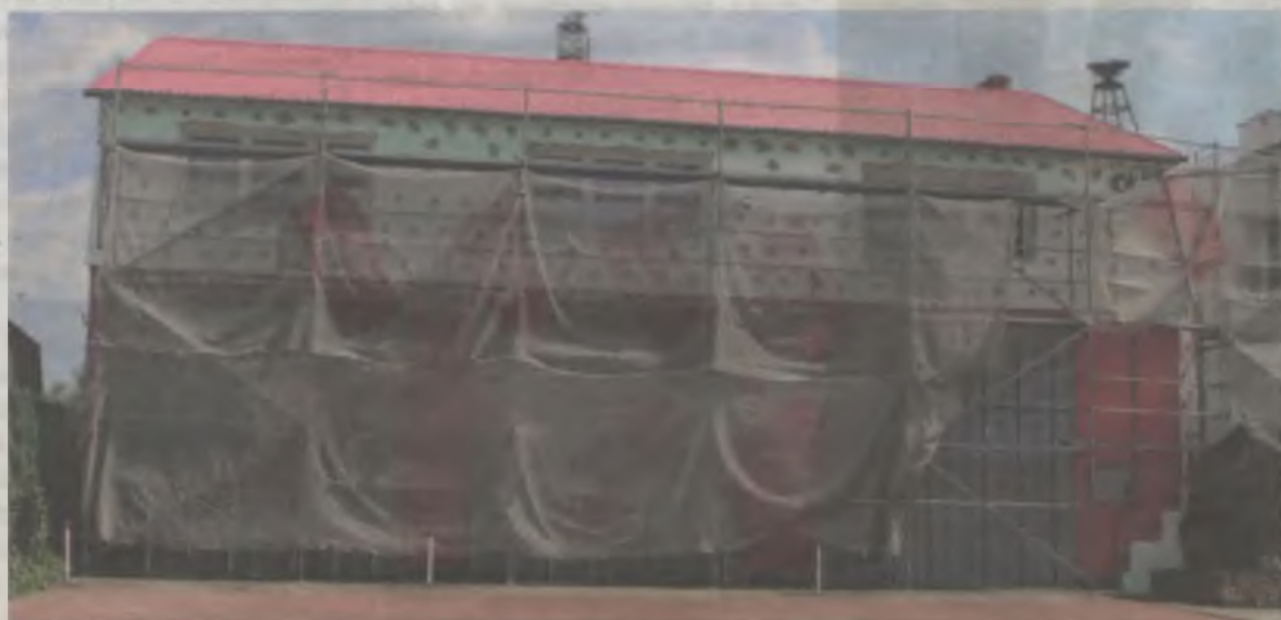
Wjazd do garaży uniemożliwia rusztowanie.
